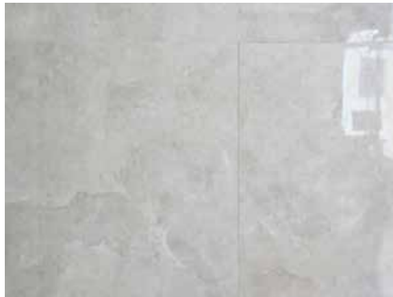
Figura 86. Revestimiento de Cerámica Para todos los Sanitarios de la Edificación.
