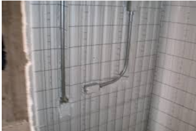
Figura: Mpanel con instalaciones eléctricas.
