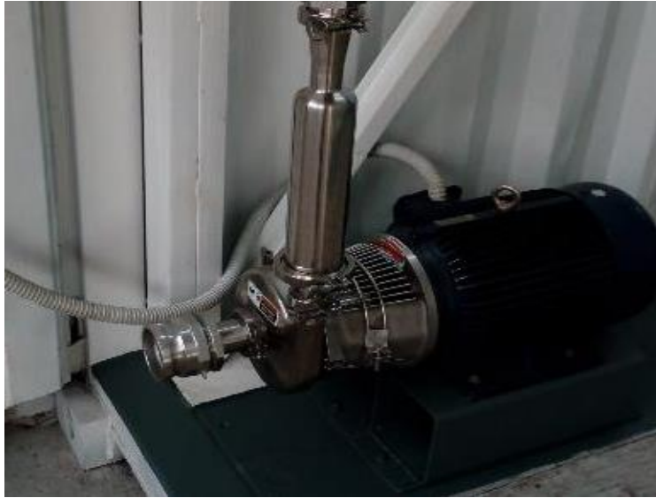
Figura 49: Bomba con filtro de línea y conexión clamp.
