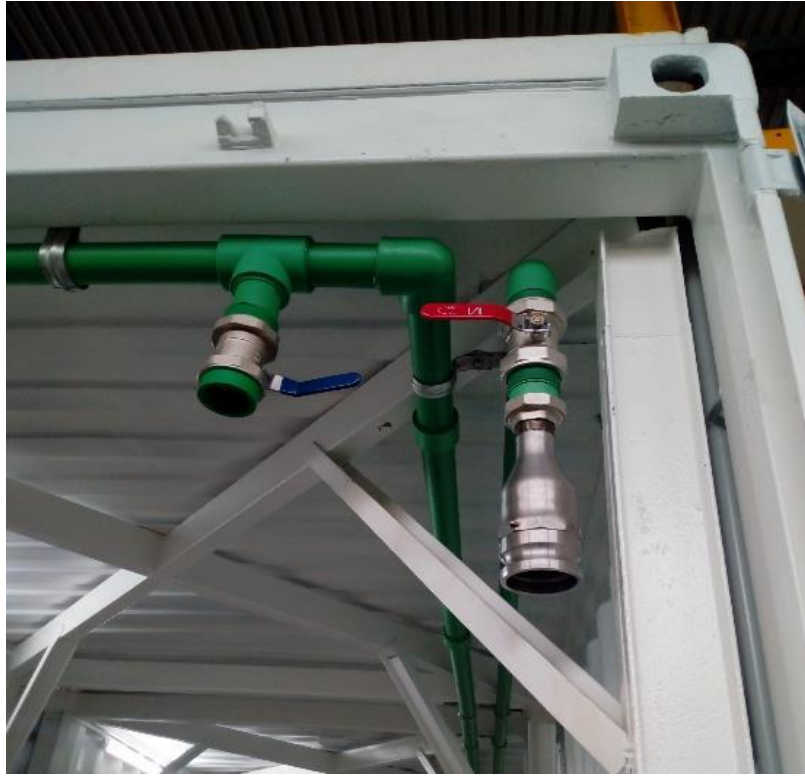
Figura 54: Tuberías de llenado y descarga.
