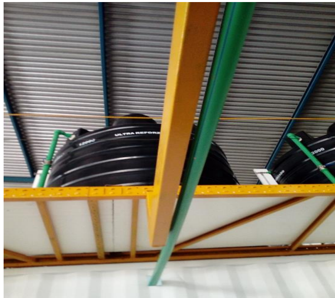
Figura 53: Tubería de descarga a la línea de producción.
