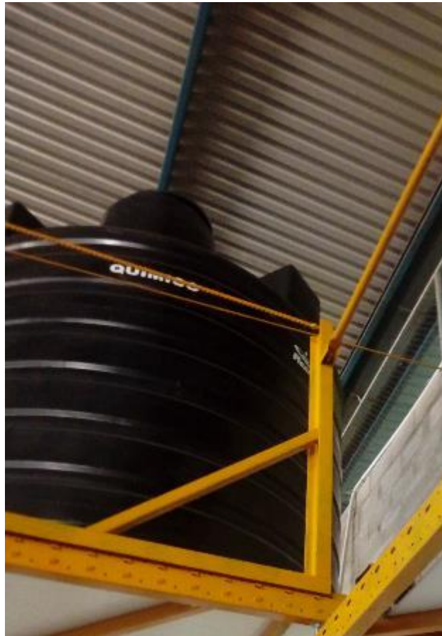
Figura 50: Ubicación de tanque N°1.
