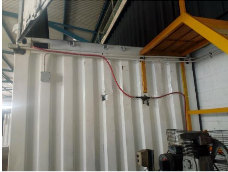
Figura 58: Instalaciones de aire comprimido.
