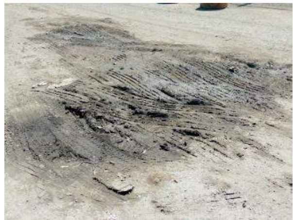
Hueco con material de relleno Durán y Rondón (2023)
