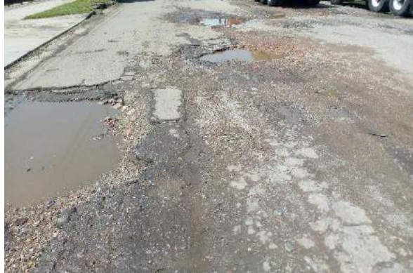
Figura 2. Condiciones del pavimento
