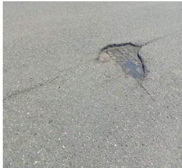
Hueco y Grieta longitudinal Durán y Rondón (2023)
