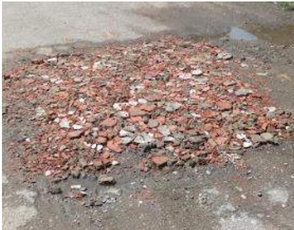
Hueco con material de relleno Durán y Rondón (2023)
