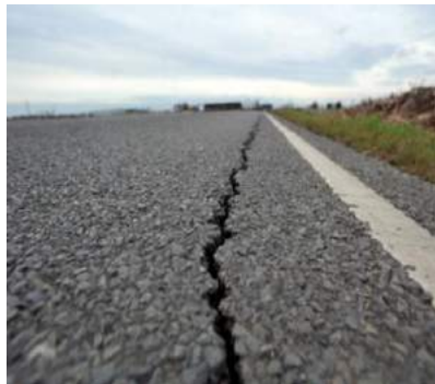
Figura 13. Grietas de Borde. Fuente: Geotexan.
