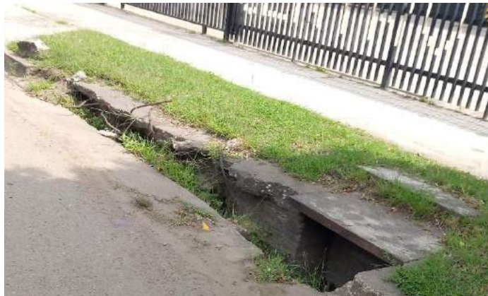
Figura 33. Drenaje con acero expuesto Autores: Durán y Rondón (2023)
