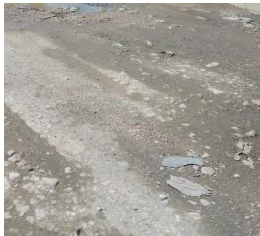
Figura 46. Disgregación del Pavimento
