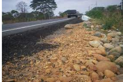
Figura 15. Falla de Desnivel.
