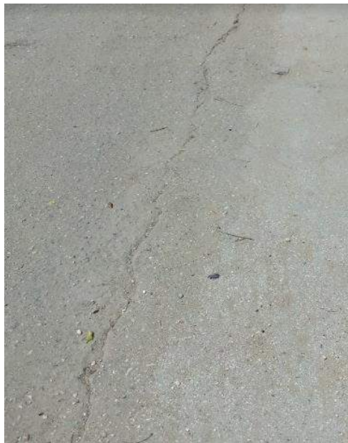
Figura 50. Agrietamiento Longitudinal. Autores: Durán y Rondón (2023)
