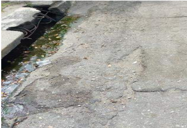
Acero expuesto y Disgregación Durán y Rondón (2023)
