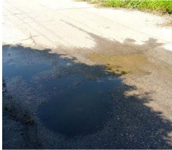
Figura 47. Falla por Hundimiento.
