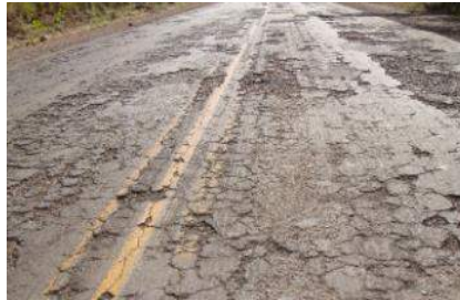
Figura 26. Disgregación de material. Fuente: Feira Quinta
