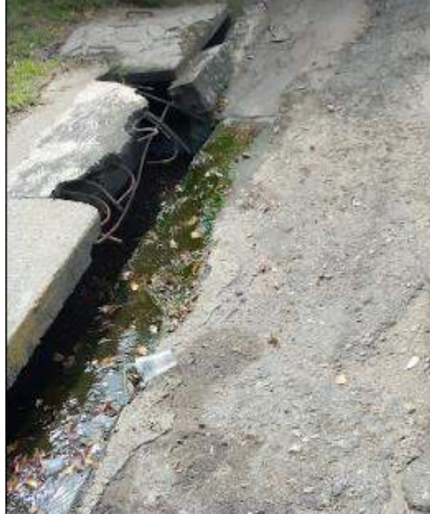
Figura 49. Drenaje con acero expuesto Autores: Durán y Rondón (2023)
