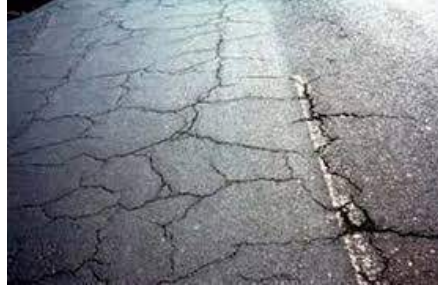
Figura 7. Falla Piel de Cocodrilo. Fuente: Catálogo de fallas.
