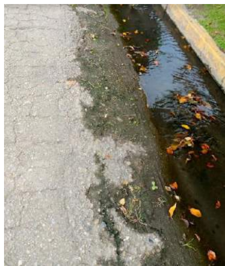
Figura 48. Falla de Borde
