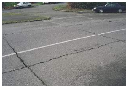
Figura 14. Grietas de Reflexión. Fuente: Corredor, G. y Corros, M.
