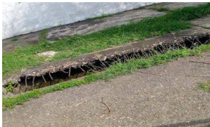
Acero expuesto en drenaje de ventana Durán y Rondón (2023)
