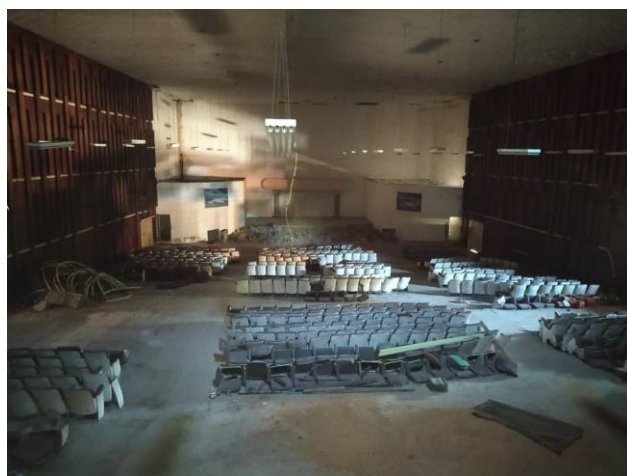
Figura 10. Estado actual del área de butacas, Teatro Guaparo. Fuente: La autora (2022)
