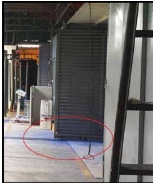
Figura 18. Escape de pintura en polvo de la cabina de pintura.
