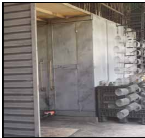
Figura 14. Horno industrial de la línea de pintura electrostática.
