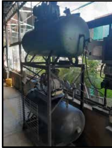
Figura 13. Compresores de la línea de pintura.
