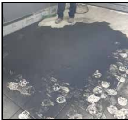
Figura 15. Pintura no adherida en el piso de la cabina de pintura.
