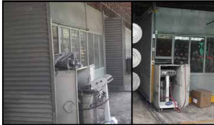
Figura 11. Cabina y maquina de pintura electrostatica
