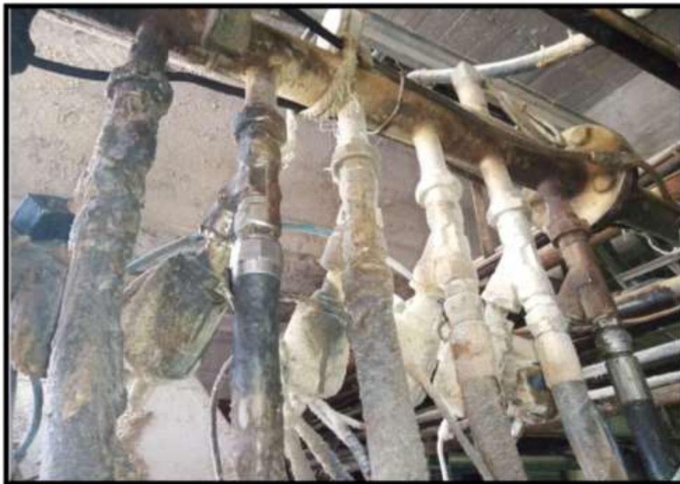
Figura 4. Condiciones actuales de los inyectores del sistema del Couter Fuente: Planta ABA Valencia, Proagro C.A. (2022)
