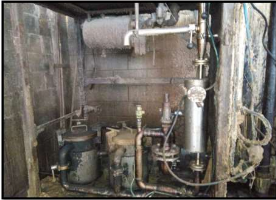
Figura 3. Condiciones Inadecuadas del Sistema del Couter Fuente: Planta ABA Valencia, Proagro C.A. (2022)
