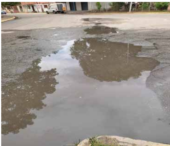
Figura 63: Deterioro del sistema hidráulico.
