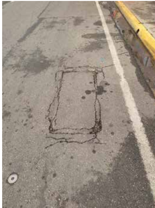
Figura 53: Grieta de contraccion
