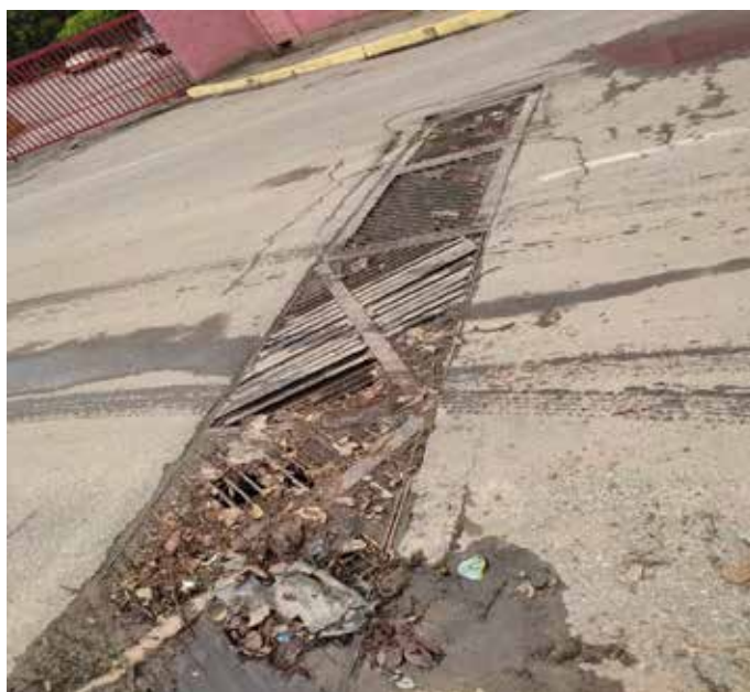
Figura 64: Deterioro del sistema hidráulico.
