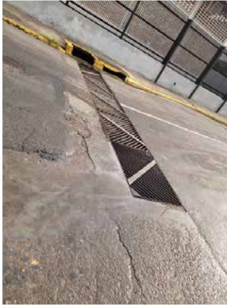
Figura 55: Cruce de sumideros de rejilla
