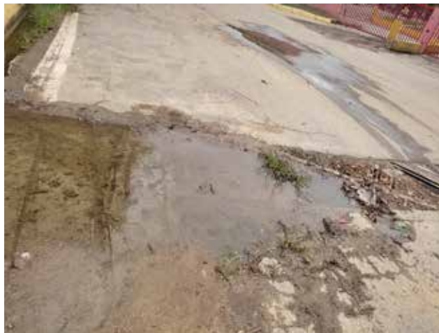
Figura 62: Deterioro del sistema hidráulico.
