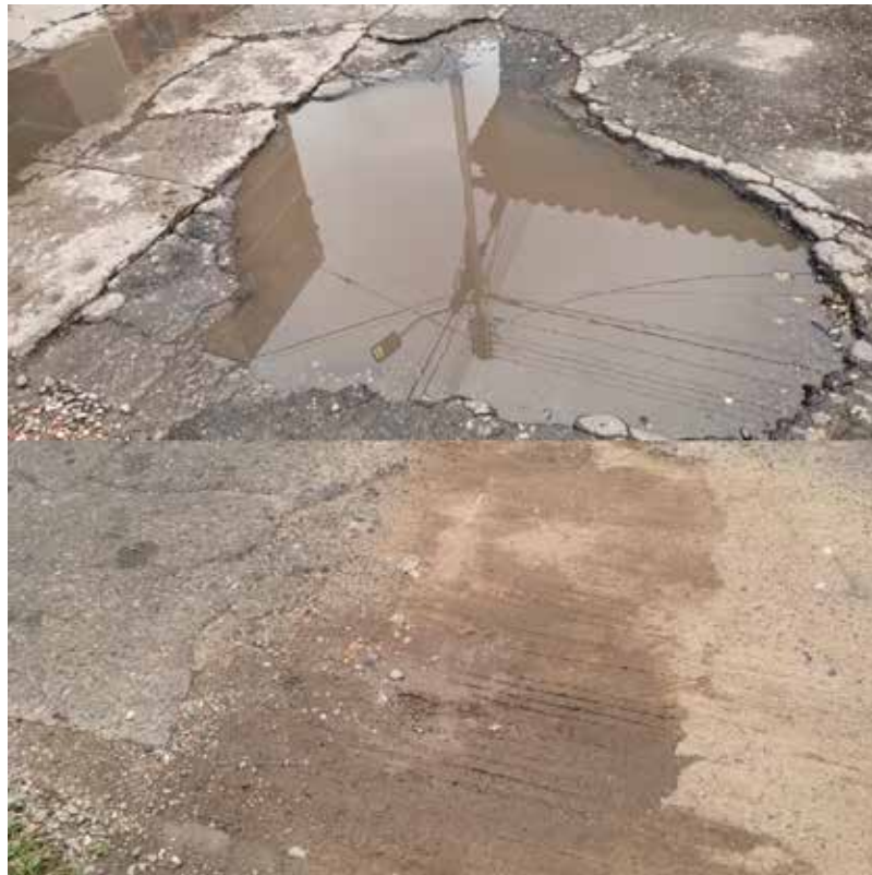
Figura 1: Condiciones de las vías del Municipio Guacara
