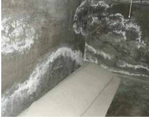
Figura 3. Eflorescencia en un muro.
