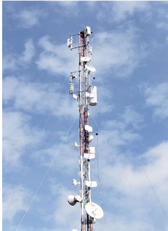
Figura 21. Torre de la celda, donde se aprecian las antenas sectoriales y las troncales de la empresa.
