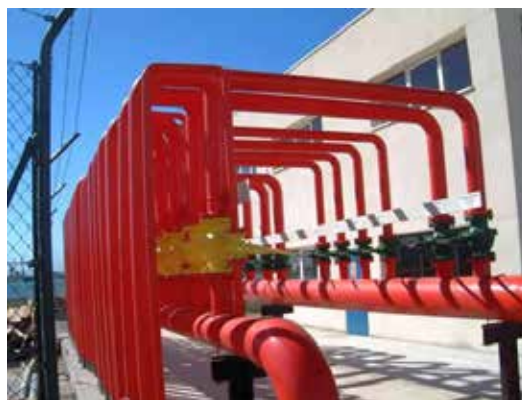
Figura 27: Tuberías Contra Incendios. Fuente: http://www.cotomac.com/wp-content/gallery/inst-contra-incendios/instalacion-contra-incendios-1.jpg
